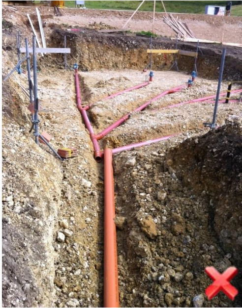
Canalisations SANS assise bétonnée !
