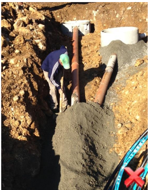
Canalisation bétonnée seulement en dessus !
